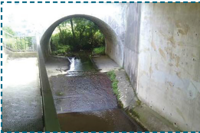
Station de suivi des étiages et du débit par courbe de tarage (B2-7.11) : Pont de Chez Meunier (PT_SUZ_04)
