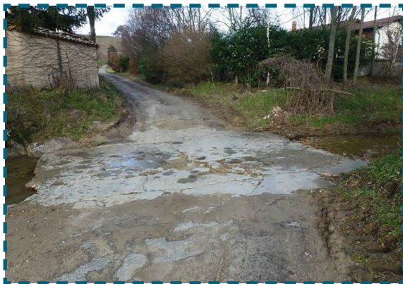
Projet de remplacement du Gué par un portique sur la Vésonne (PT_VES_09)
